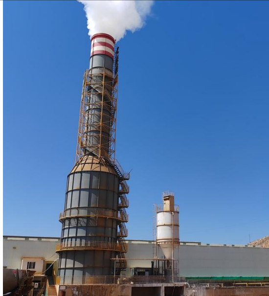
湿式双碱法脱硫塔
