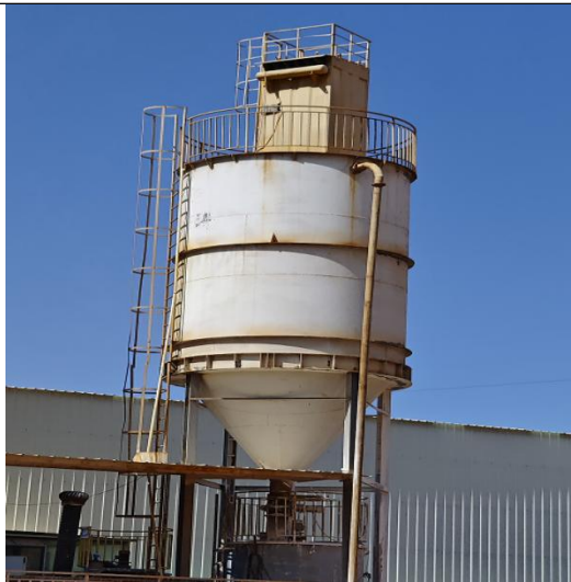
石灰粉储料仓
