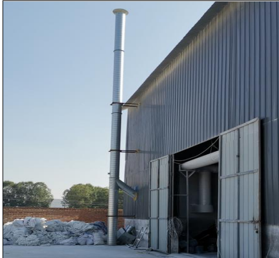
破碎工段排气筒
