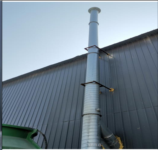
热熔工段排气筒
