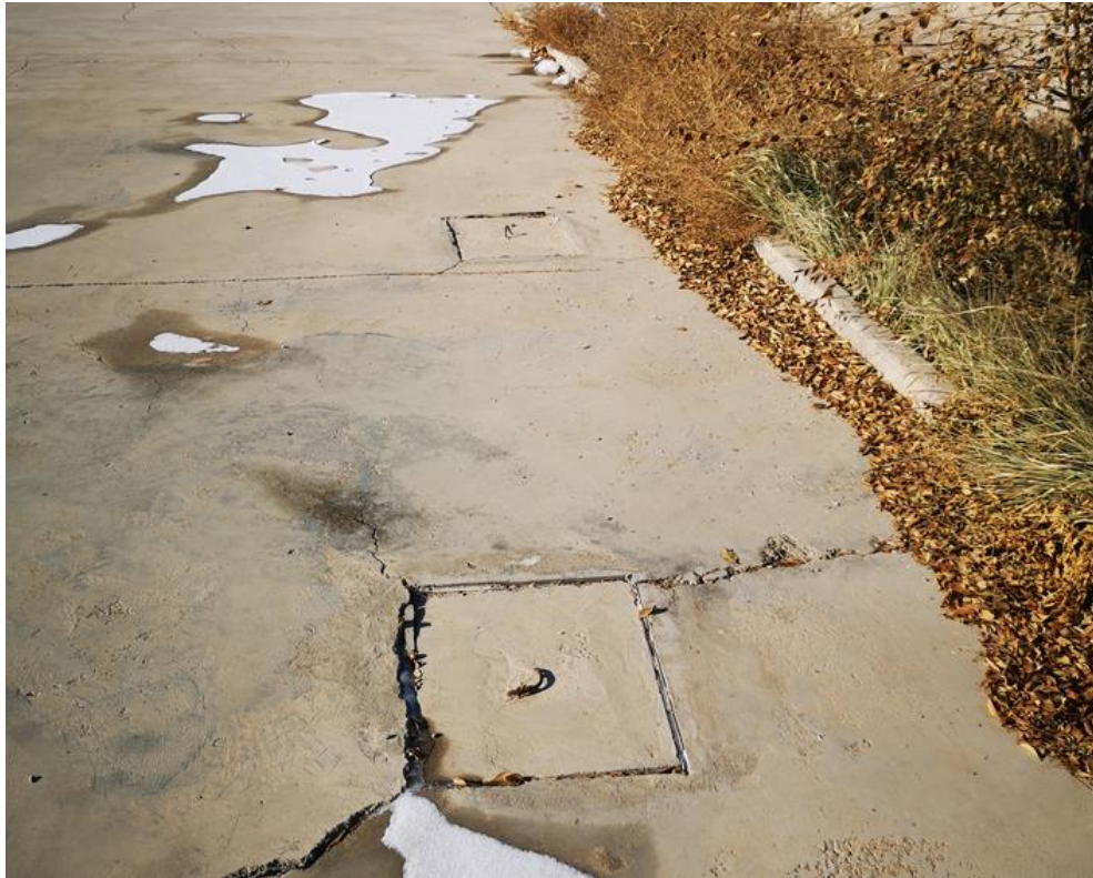
化粪池、隔油池
