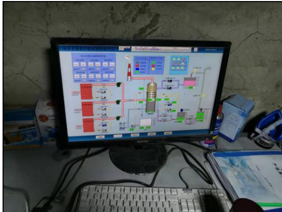
DCS 控制系统
