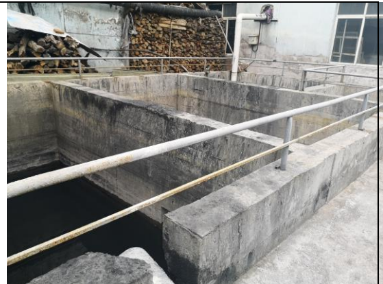
脱硫循环水池
