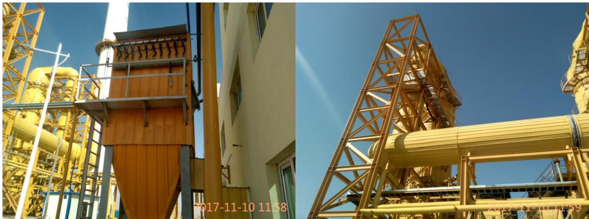
碎煤楼布袋除尘器
